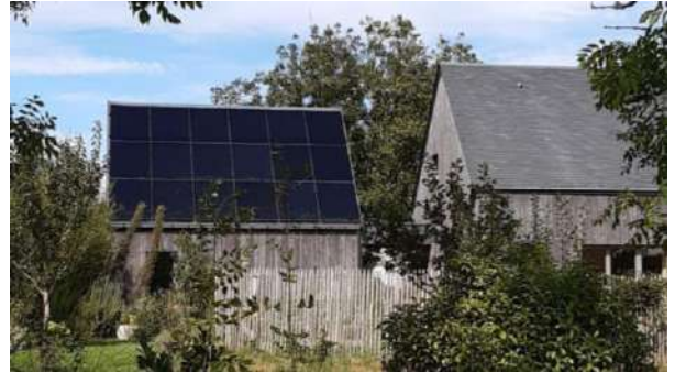
Panneaux formant la couverture complète d'une annexe, en Bretagne. La taille de la construction a été adaptée en fonction des dimensions des modules.
