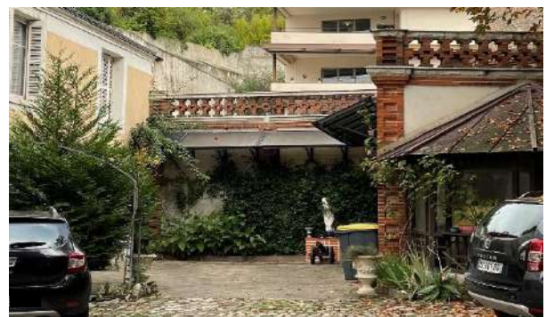
Panneaux installés sur des consoles métalliques formant une sorte de marquise positionnée le long d'un bâtiment sur cour à Saint-Cyr-sur-Loire (37).
