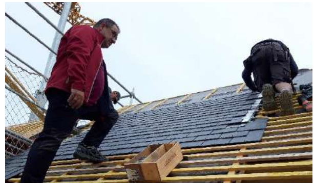
Panneaux thermiques sous une couverture en ardoises, au sein d'un Site Patrimonial Remarquable à Vendôme (41).
